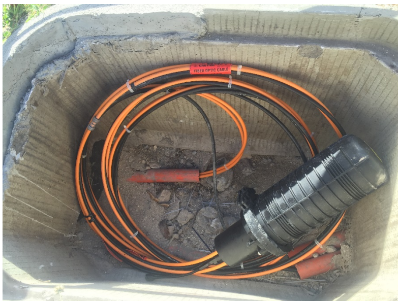
Tous les câbles et micro-conduits sont lovés et étiquetés
